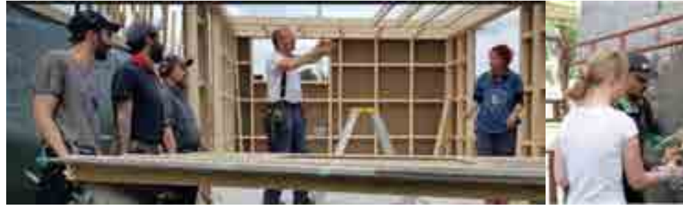
Deltagare i en byggemenskap deltar i alla delar i byggprocessen allt ifrån tidiga faser i planering av bygglov och byggnadernas gestaltning/utformning till det praktiska byggandet som sker med stöd av professionella hantverkare. Bilder: Egnahemsfabriken.se
